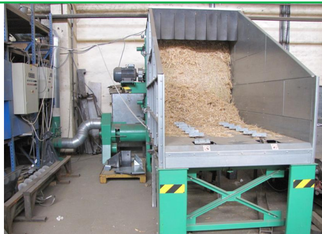
Három-hengeres durva aprító, darabos anyag leválasztó, pneumatikus szállító, vezérlő egység
