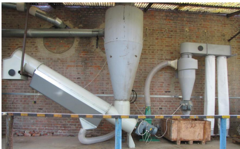
6. ábra Ciklon, ferde rostélyos leválasztó, porzsákok
