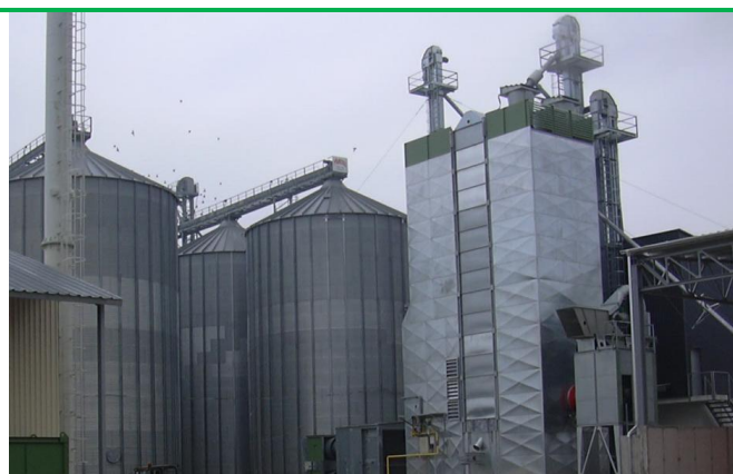
Toronszárító silókkal, hőcserélővel és kazánházzal
