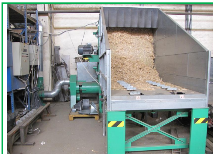
Három hengeres durva aprító, darabos anyag leválasztó, pneumatikus szállító, vezérlő egység
